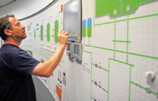
Wassermeister Klaus Steves an der Schalttafel des Wasserwerks Lobberich
